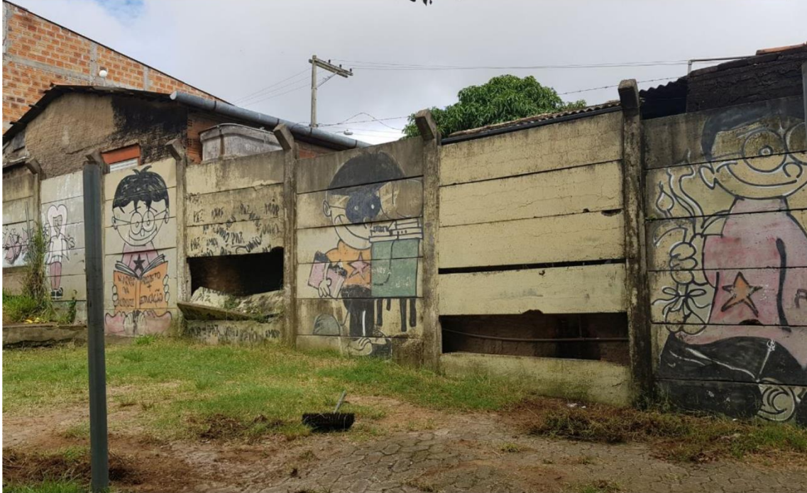
Muro sem manutenção, com estrutura danificada
